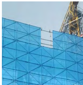
局部网片固定不牢、 脱落
