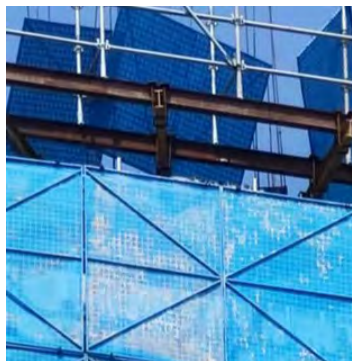
网片混凝土污染未 及时清理
