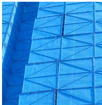
网片拼缝不顺直， 局部网片歪斜
