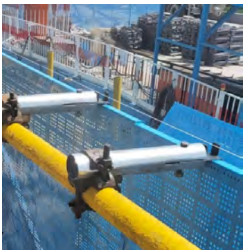
螺栓松动、连接件 后端伸出长度不足
